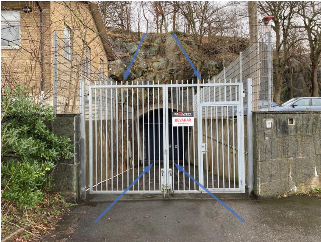
Figur 6. Nedfart till fjärrkylanläggning inom fastighet Noten 20 (Foto: Atkins, 2022-02-17).
