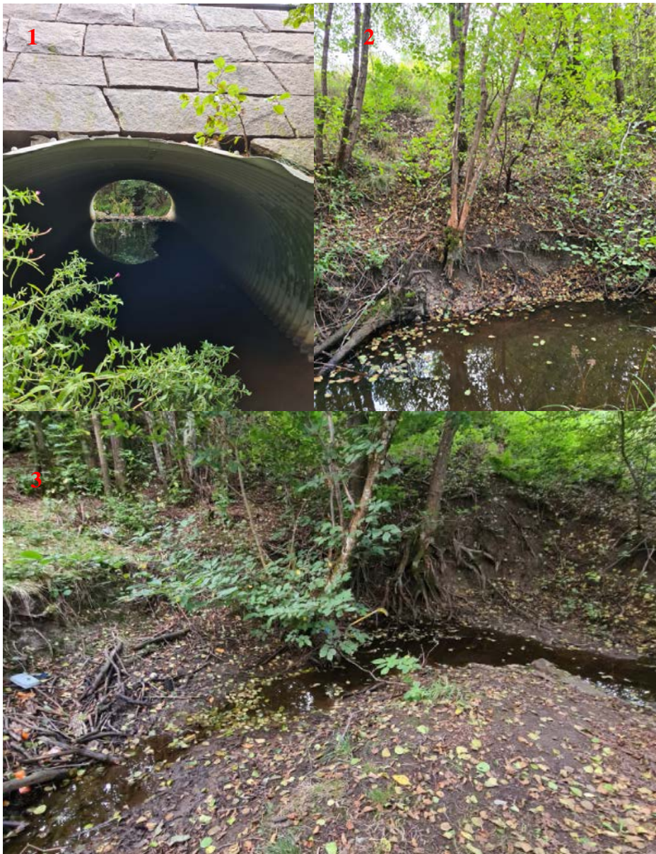
Figur 3-2 - (1) Bro med korrugerad plåtkulvert. (2) Pågående erosion. (3) Bild tagen från en ”ö” i bäckfåran med spår av skred och erosion.
