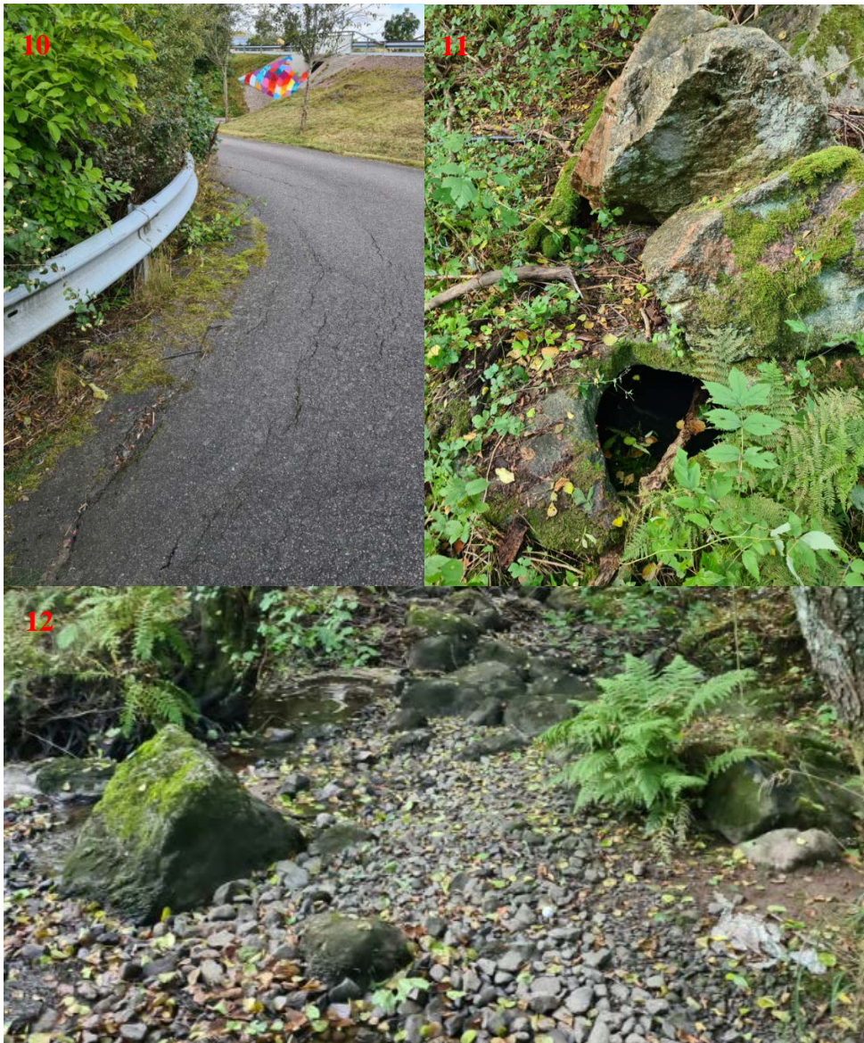
Figur 3-5 - (11) Pågående rörelser vid väggkant, tecken på ett pågående skred. (12) Brunn i nedre kant av slänt på södra sidan. (13) Block, sten och grus i bäckfåran.
