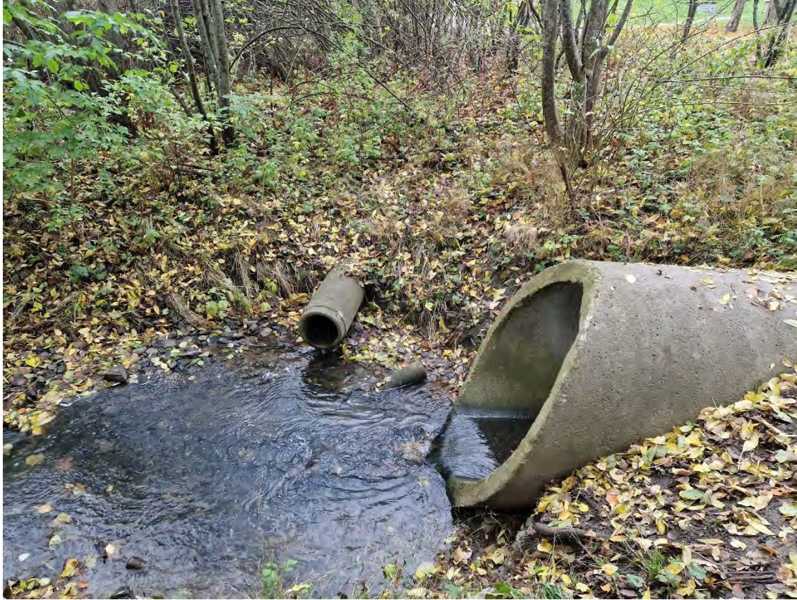
Figur 33. Åtgärdsförslag 33 – Sänkning av trumma.
