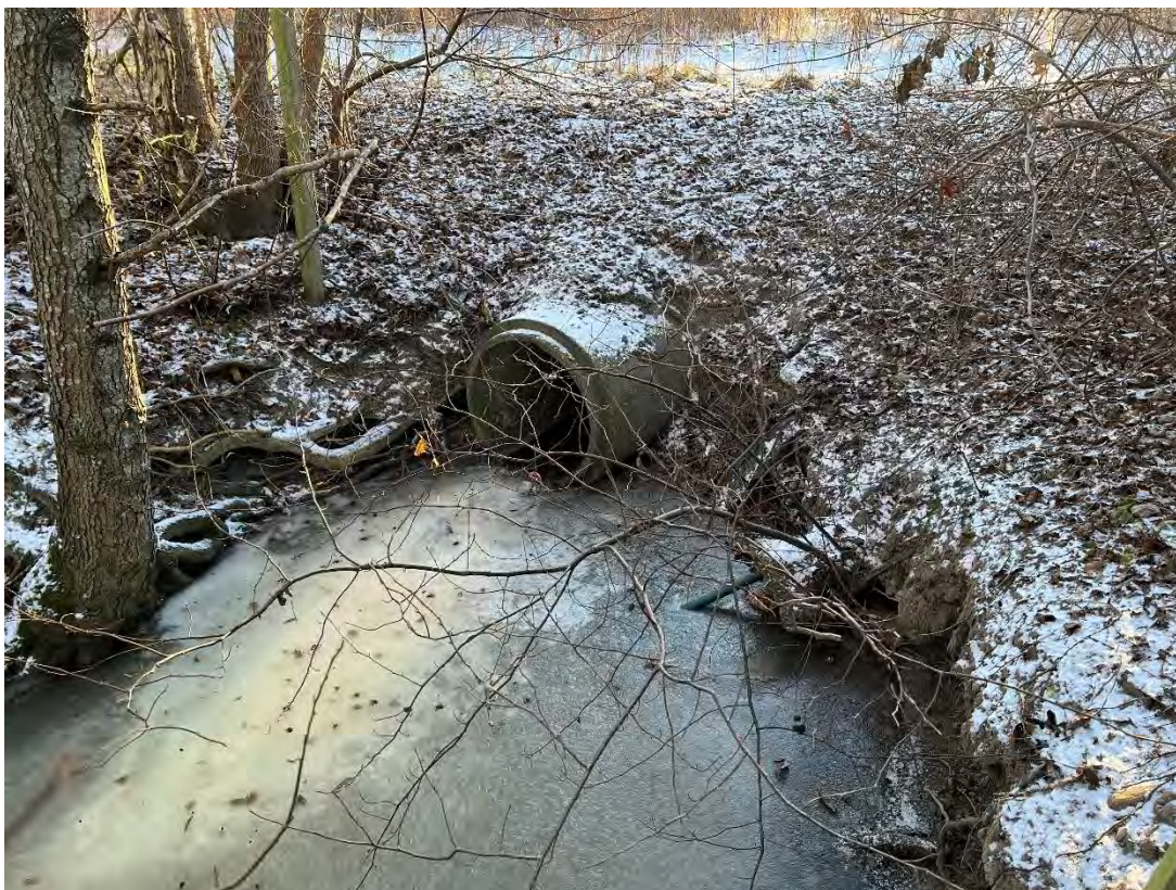
Figur 35. Åtgärdsförslag 13 – Tröskling av trumma.
